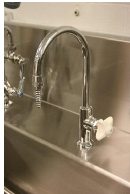
DI and RO water Faucets
